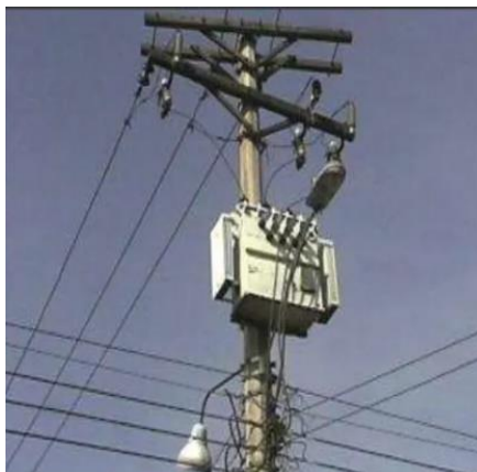
Figura Subestación aérea
